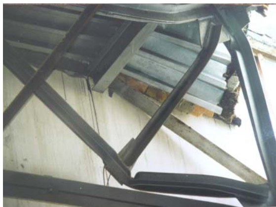
Рис.1. Аварийное состояние ферм одного из цехов ООО «Пензхиммаш»
