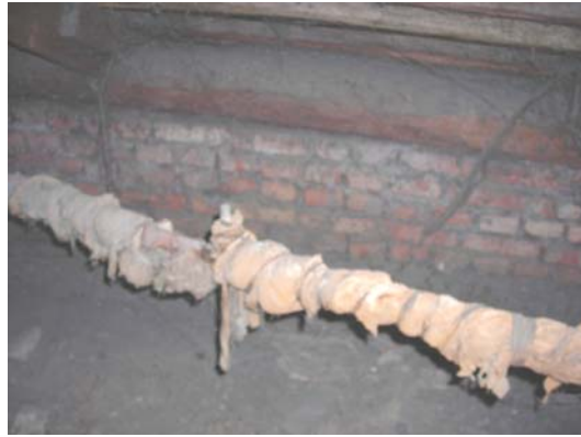
Рис. 2. Состояние изоляции труб системы отопления (магистраль)
