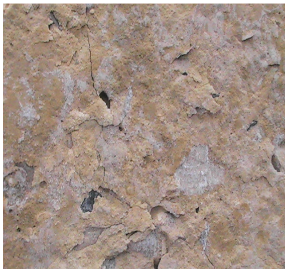
Рис. 2. Разрыв сплошности шлакощелочной матрицы вокруг доломитизированного заполнителя и образование поверхностных трещин
