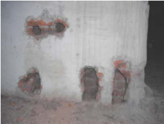
Рис. 3. Отверстия, пробитые в стенках вентканалов
