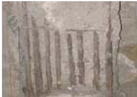
Рис. 3. Обрушение защитного слоя бетона из-за коррозии рабочей арматуры и накопления продуктов коррозии – ржавчины
